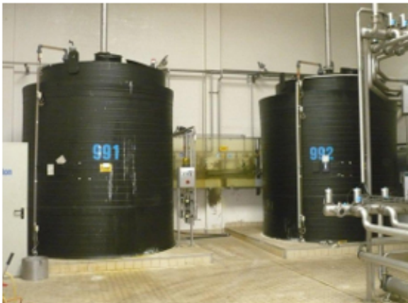
Tanques + cubas de retenção em PEAD com virolas de extrusão-enrolamento
