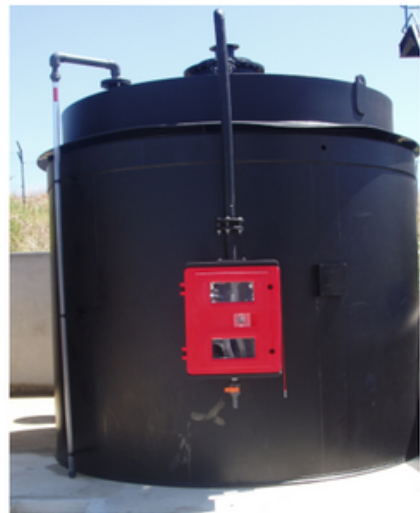
Depósito com cuba de retenção (ETA do Enxoé): construção civil simplificada, menor espaço ocupado. Ausência de acessórios laterais. Obrigatório a aspiração de produto por picagem superior. Na foto armário de carga em PEAD
